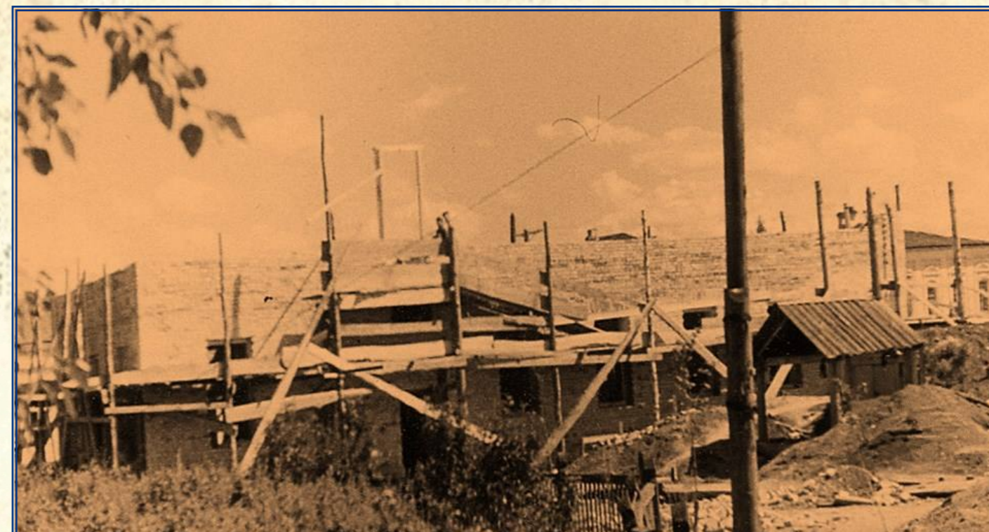
Строительство зданий районной больницы. Фотография. ГКУСО «ГА в г. Ирбите». Ф. Р-461. Оп. 5. Д. 1. Л. 3.
